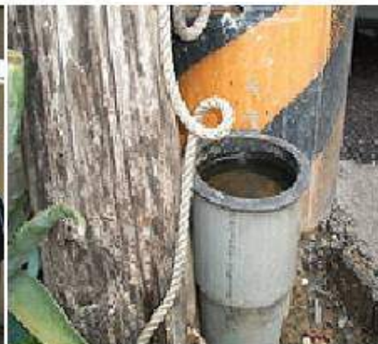
台電地下電纜引上管
