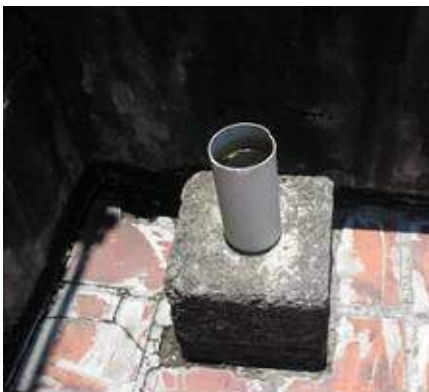
水泥樁上之水管
