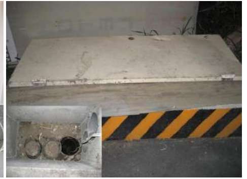
電信電纜管道
