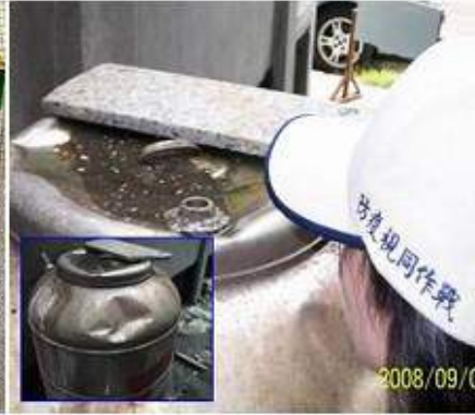
儲水桶鐵蓋凹陷處
