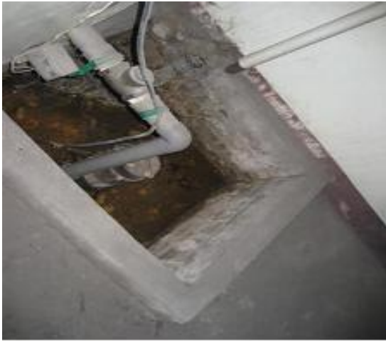
地下室儲水槽
