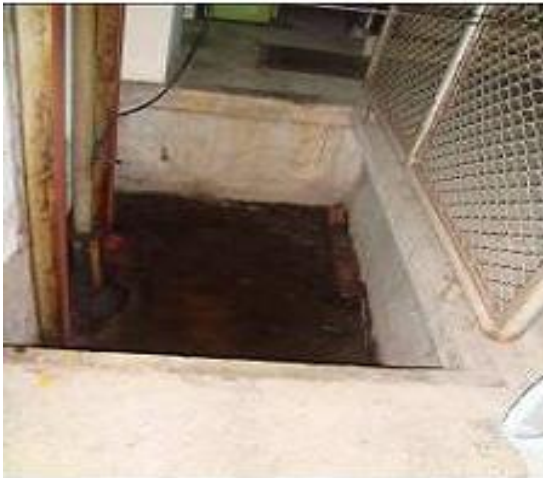
地下室之升降梯孔積水
