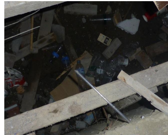
建築工地廢棄物堆積處
