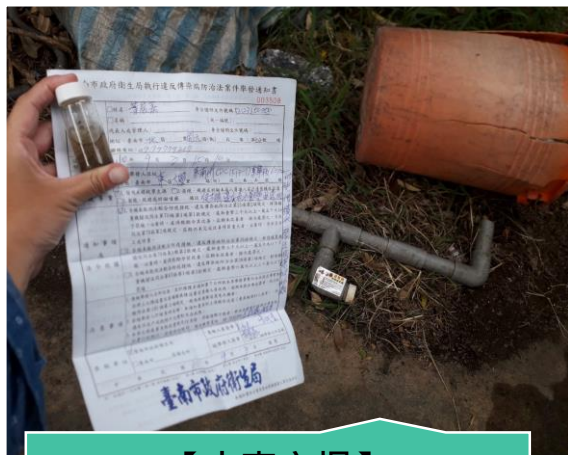
【小東市場】 灰色水管彎曲凹槽積水
