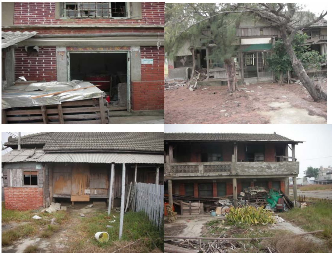
圖 5.1.1 安南區鹿耳、顯宮及四草里三里房舍之外貌老舊疑似無人居住
